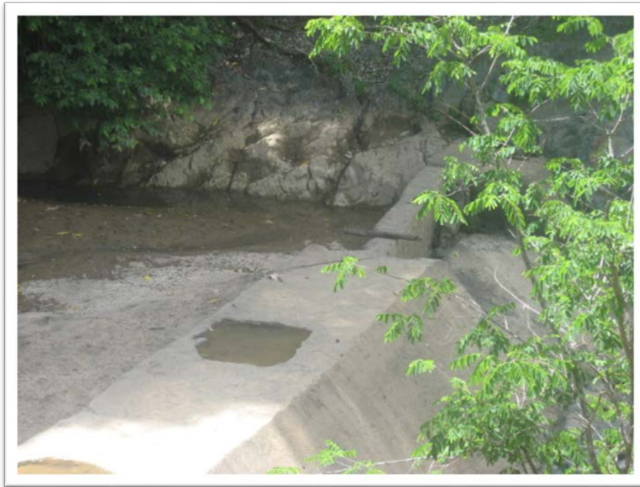
Figura 4.29. Obra de Derivación en el Sitio Río Cerro Pelao en Las Guamitas
